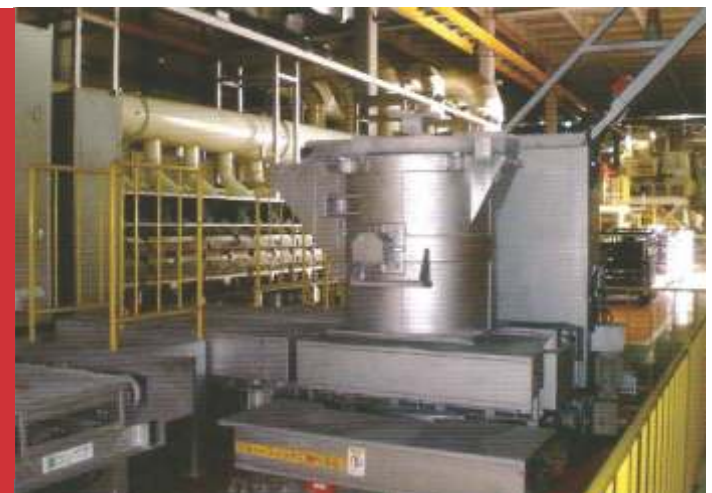
Sistema de Transferência de Metal Fundido
